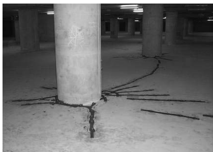
Рисунок 4: Трещины плиты основания подземной парковки
