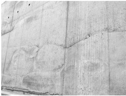
Рисунок 1: Пустоты и скопления крупной фракции в секции бетонирования стенки туннеля
